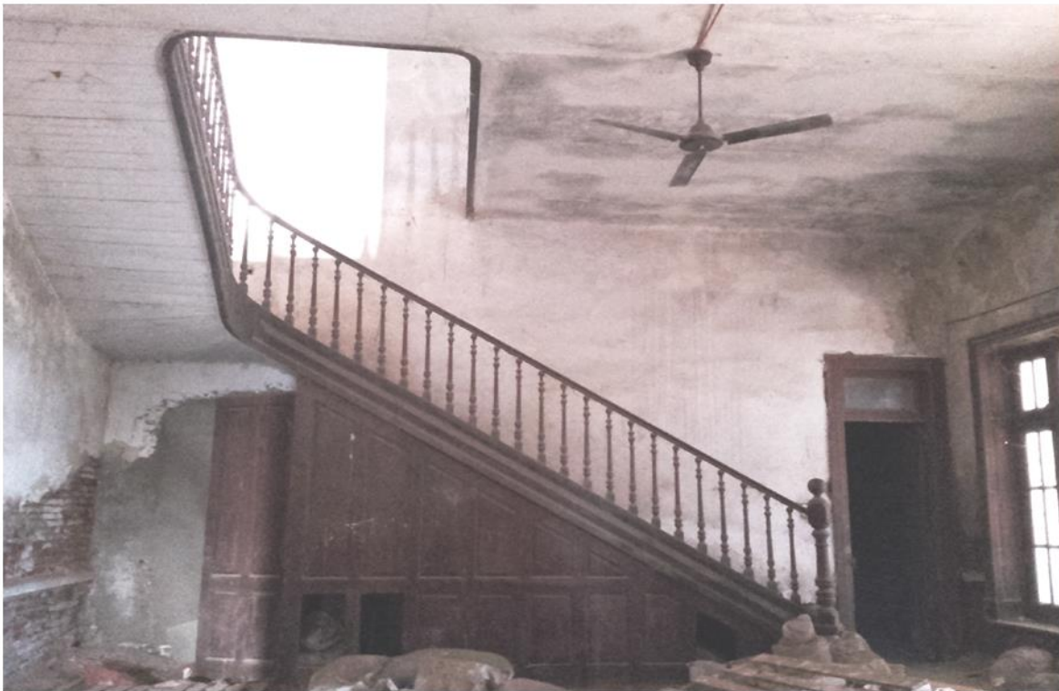
Estado actual de la escalera de madera ubicada en el salón principal.
