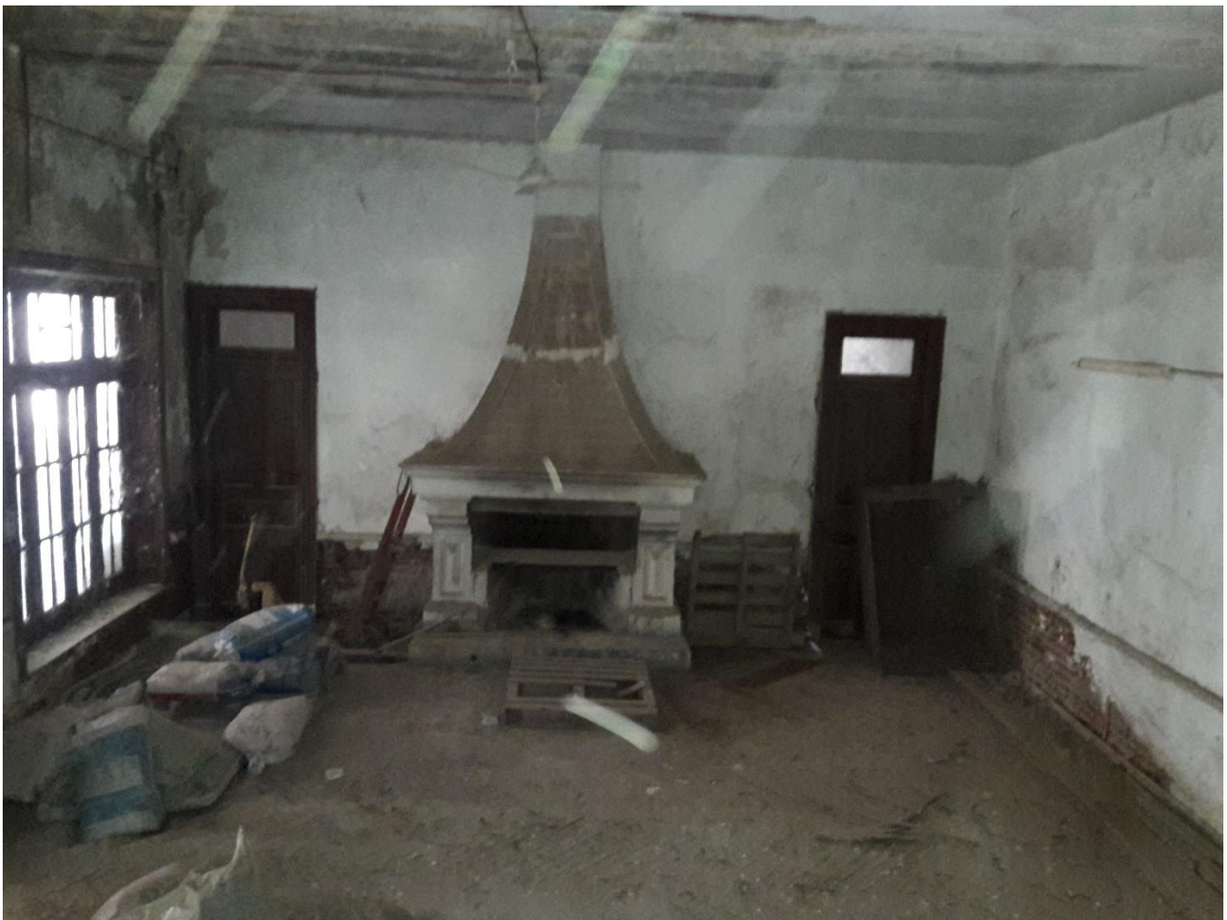
Foto actual de la Sala Principal de la casona con su gran Fogón
